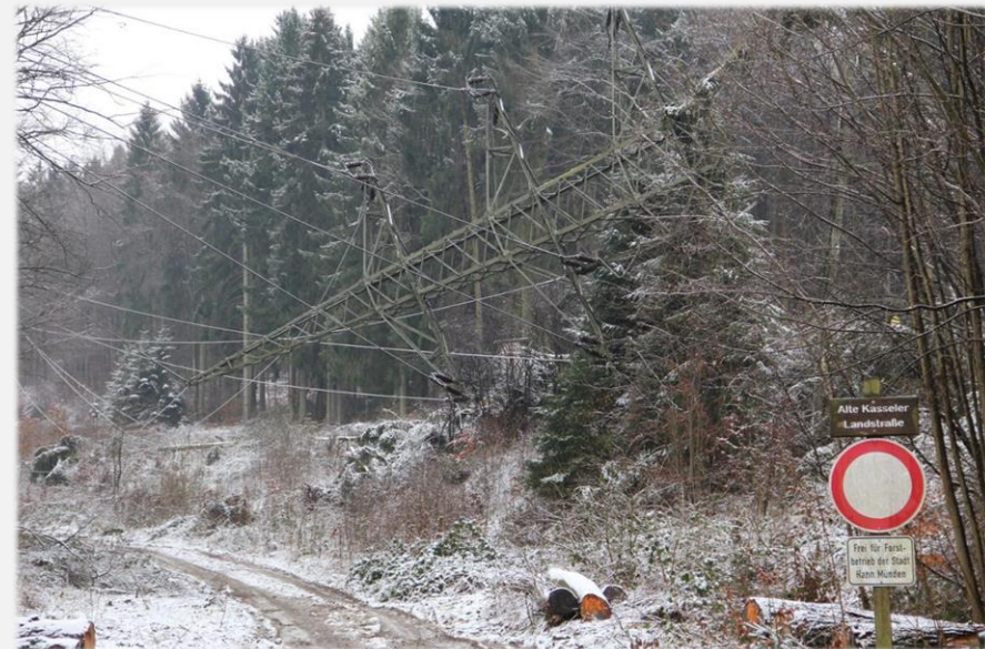
Umgestürzte 110kV Leitung im Bereich Hann. Münden
